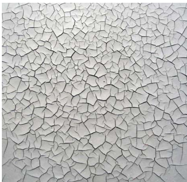
Рис. 24. Пример разрушения покрытия в процессе эксплуатации при нарушениях технологического процесса его производства
